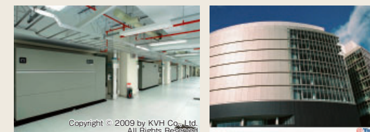
第1データセンター (KVH・ラックルーム)
